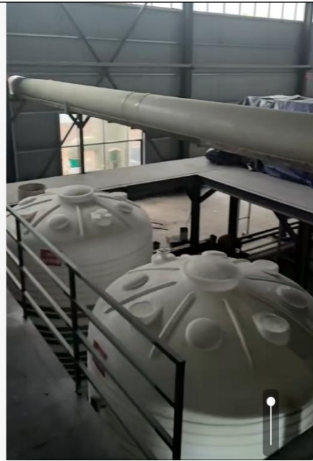
酸洗车间酸储罐结构现状
