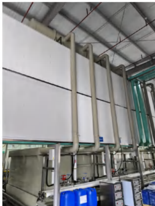
槽体侧吸收集管道
