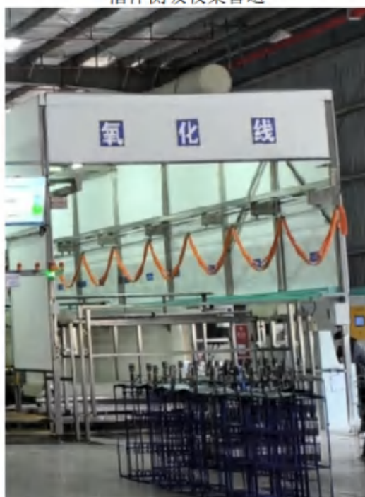
生产线顶部收集管道
