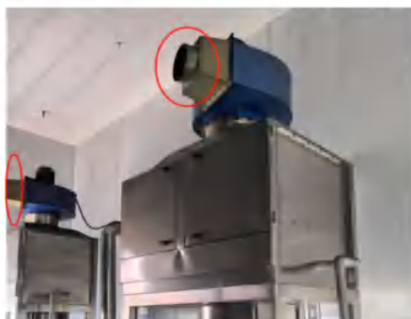
3#车间除尘器废气无组织排放
