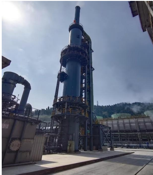
湿法磷酸装置废气处理系统及排气筒
