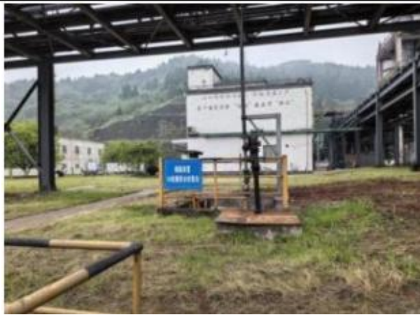
初期雨水收集池（地下池体）
