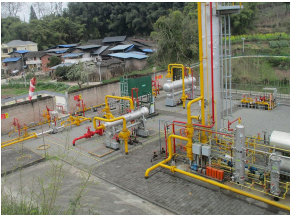
马家站工艺装置区
