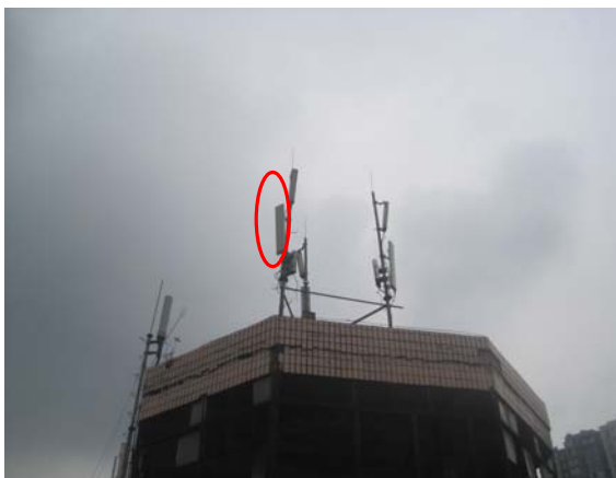
（图为通川区科技大院基站）
