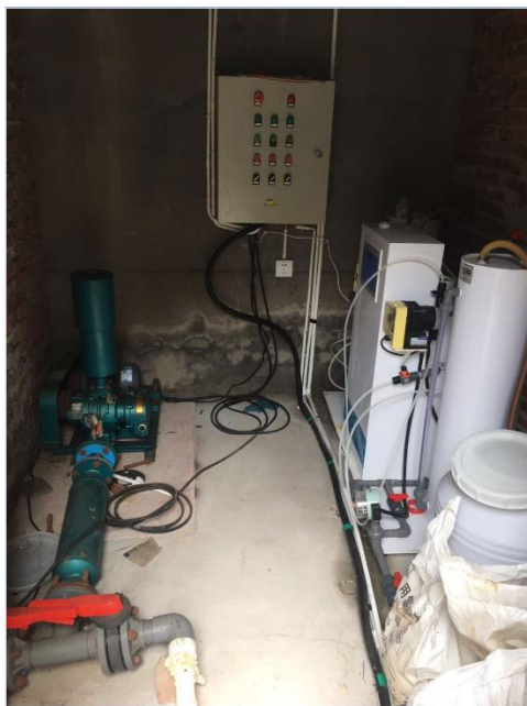
污水处理设施
