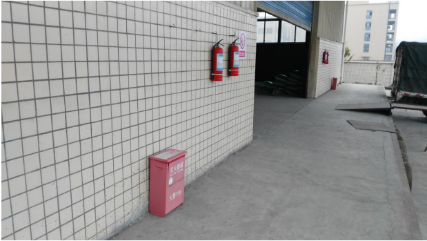
项目火灾消防设备
