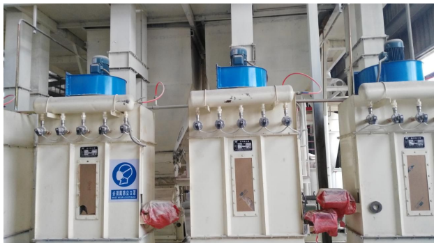
降尘除尘设备
